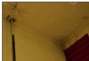
FOTO 04 - DSC_0051 Trincas e desprendimento de pintura na laje de cobertura. As manchas correspondem a antigas infiltrações, já tratadas.
