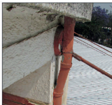
FOTO 01 - IMG_0530 Vista externa do tubo
